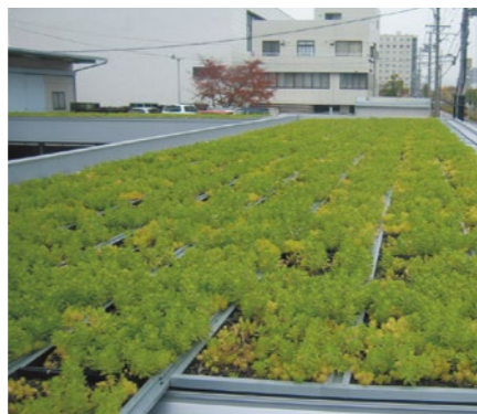
兵庫県某工場 / 128.4㎡
