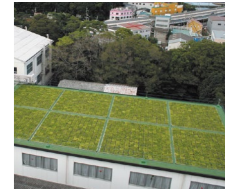
兵庫県某工場 / 500.0㎡
